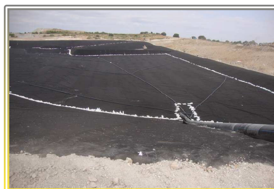
Canalizaciones de evacuación
