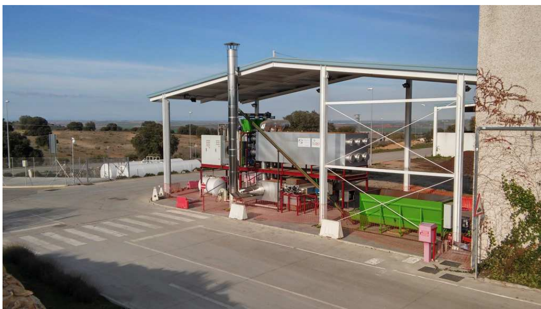
Vista general de la Planta de Biolíquidos
