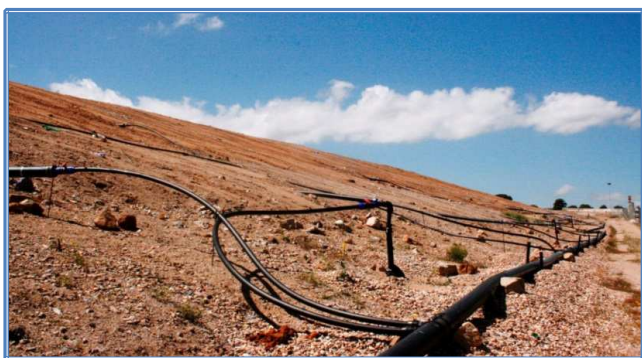
Canalizaciones de Biogas
