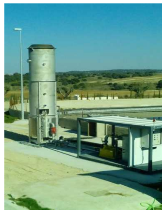
Antorcha de combustión del biogás
