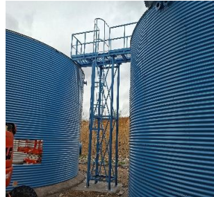
Instalación depósitos biosuspensión y agua proceso
