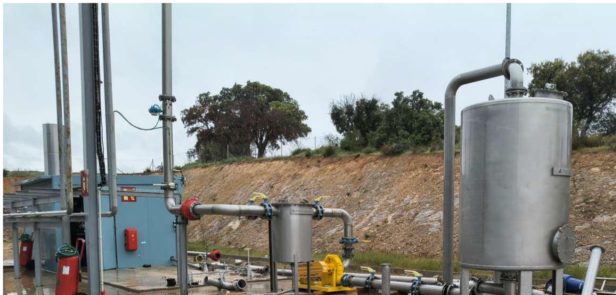
FILTRO DE CARBÓN ACTIVO PARA MEJORA DEL BIOGÁS
