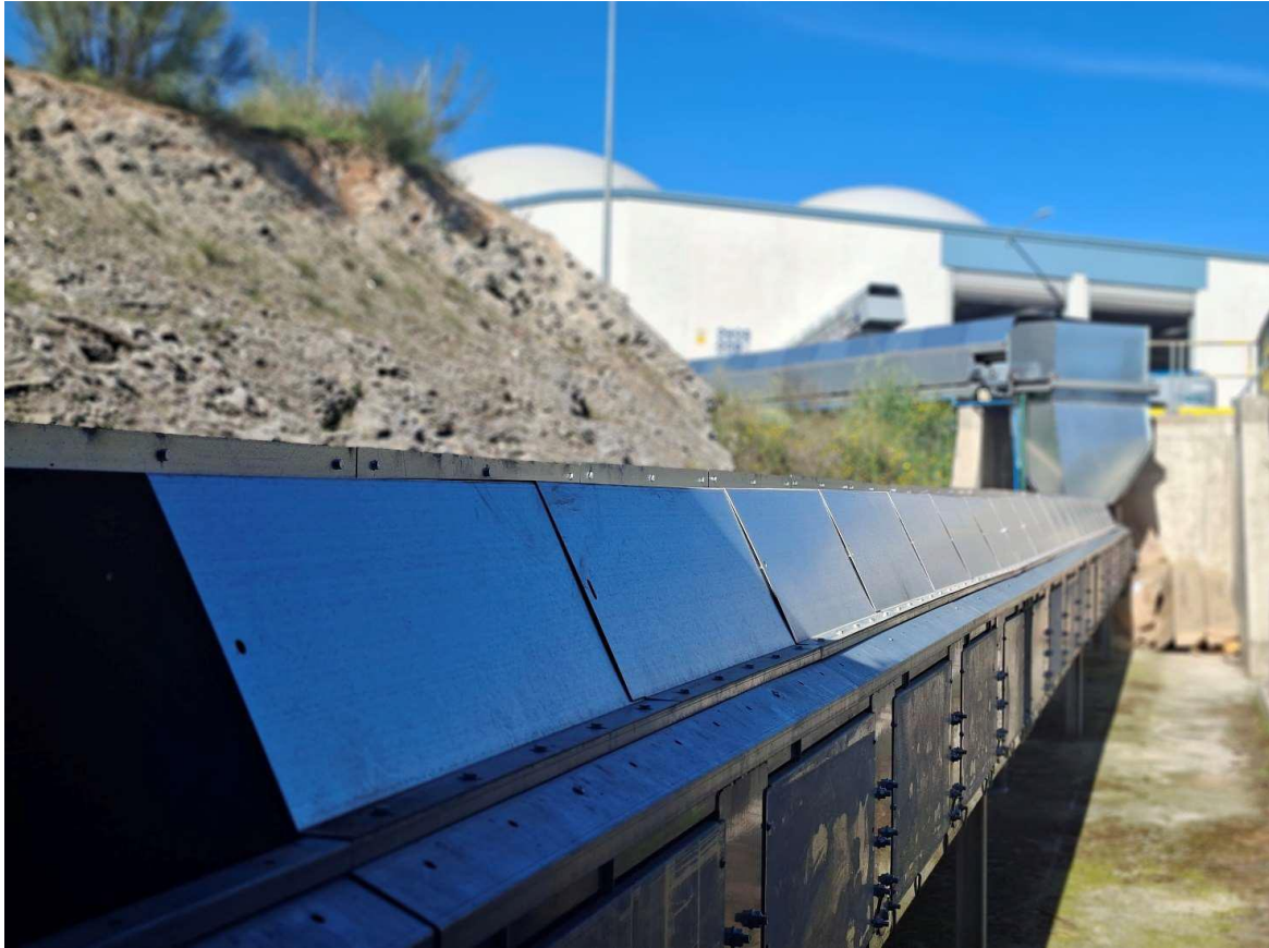
CAPOTADO DE CINTAS DE EVACUACIÓN DEL DIGESTATO HASTA COMPOSTAJE
