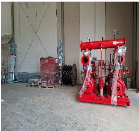
Recepción grupo de bomba PCI deposito PCI
