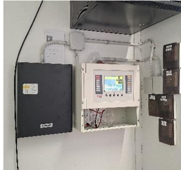
Instalación central incendios y sensores PCI
