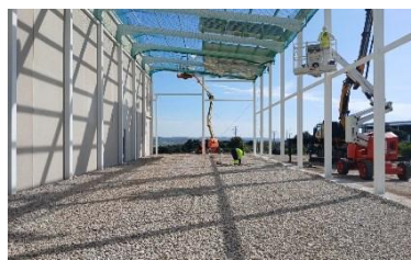
Colocación grava solera interior, continuación montaje prefabricado perimetral e inicio montaje cubierta
