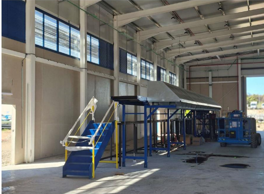
NAVE PLANTA TEXTIL: Mesa de recepción de producto, cinta para el transporte de ropa y plataforma de trabajo
